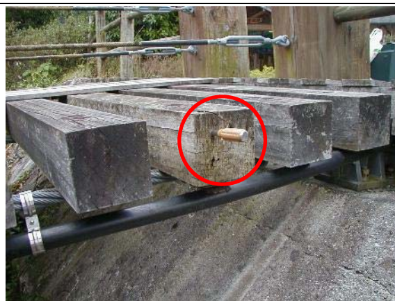
ドライバーが簡単に突き刺さるほどにボンゴシ材の内部が腐朽している。
