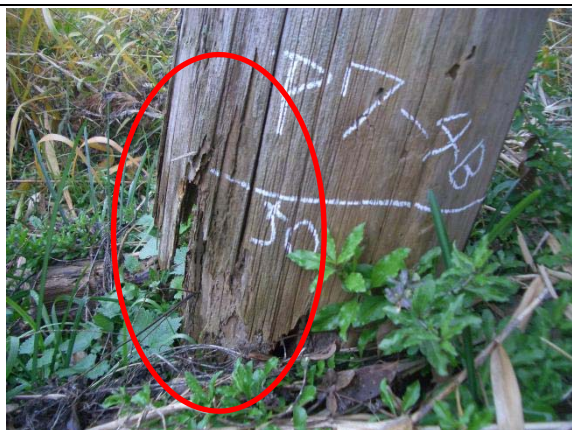
橋脚の地際部は腐朽しやすい。
