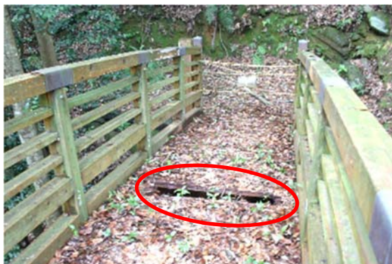
床版材が折損・脱落している。
