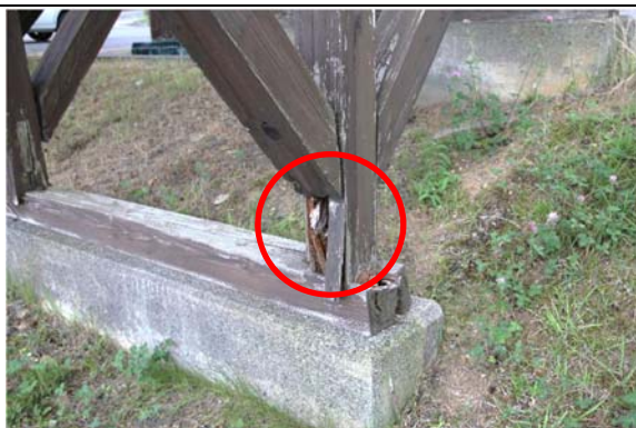
斜材取り付け箇所下部が腐朽している。
