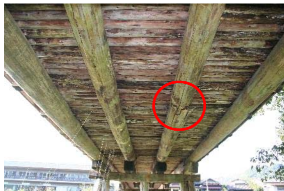
桁が曲げ破壊している。
