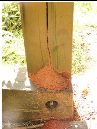
柱基部に蟻土が現れている。
