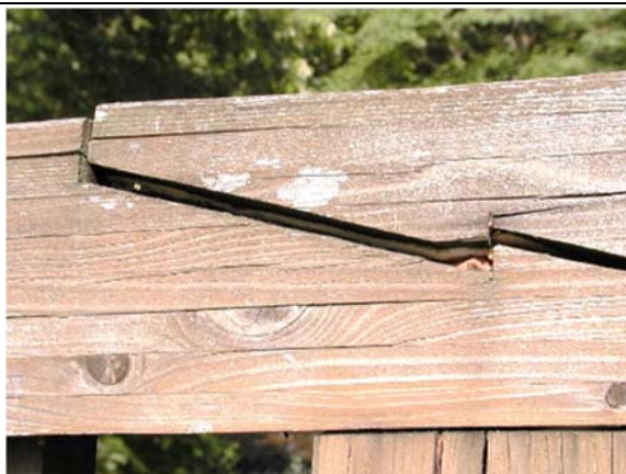
接合部分の隙間から蟻土が見える。
