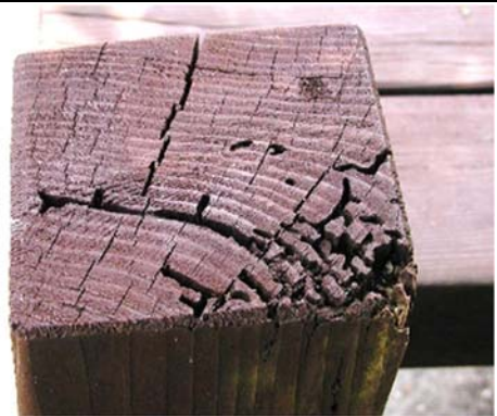
高欄柱頂部に蟻害が現れている。
