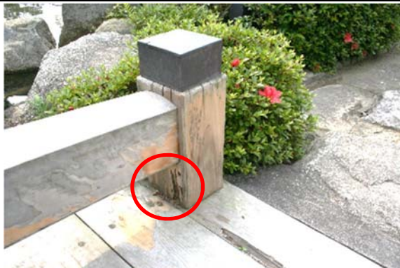
親柱の基部に蟻害が見える。
